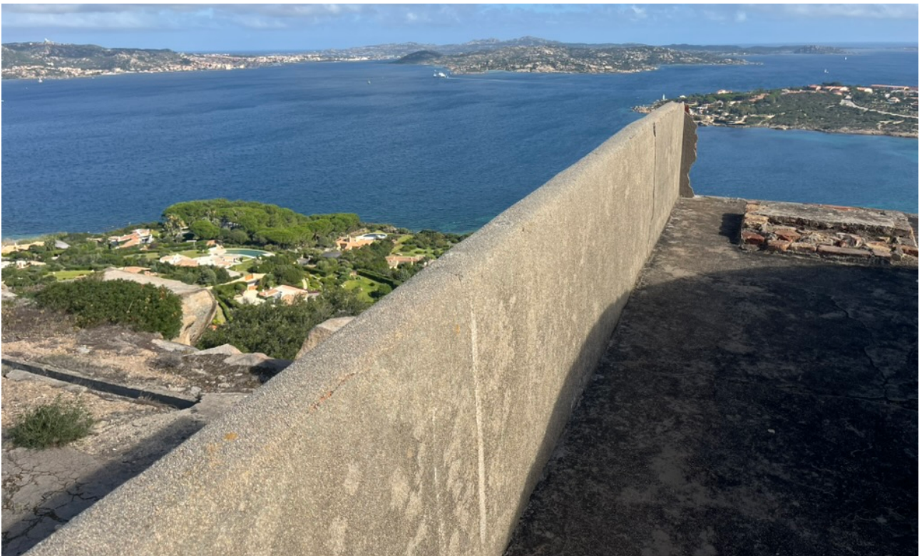
Figura 7: Parapetto esistente (postumo) da demolire
