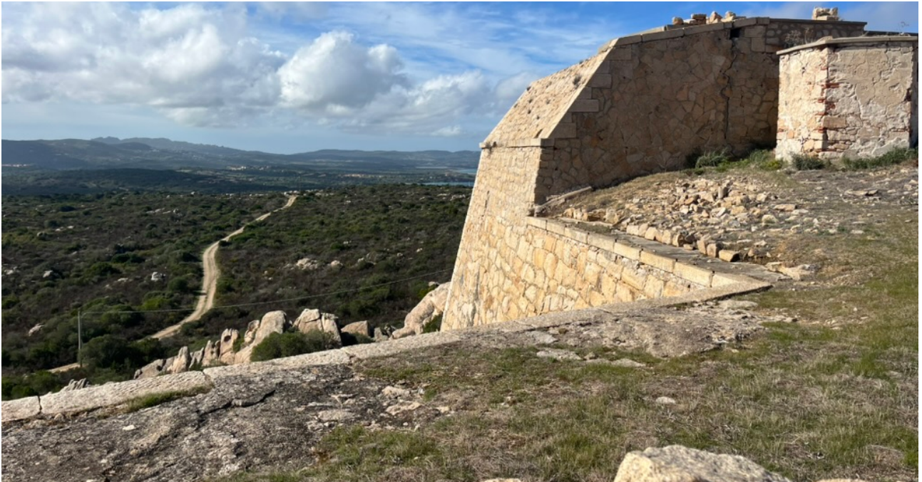
Figura 6: area terrazzata (ovest) da rendere fruibile con la messa in opera del parapetto
