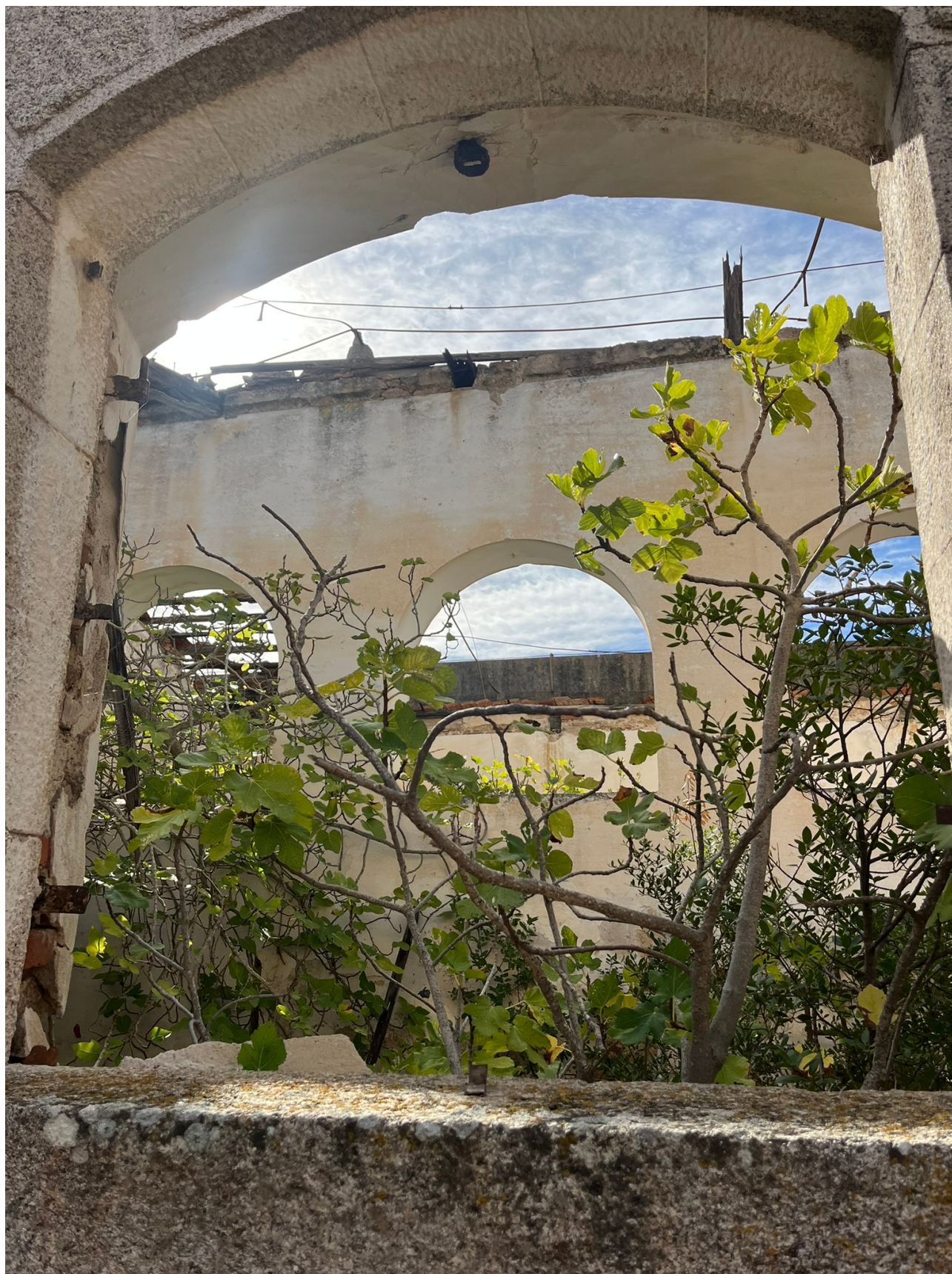
Figura 8: vegetazione invasiva all'interno del perimetro dei dormitori
