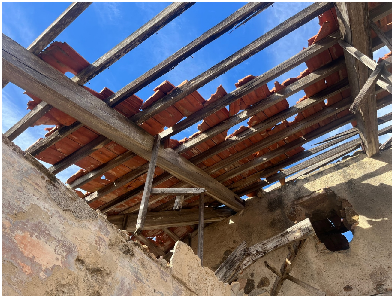
Figura 4: Dettaglio stato di conservazione delle coperture della casa del comandante
