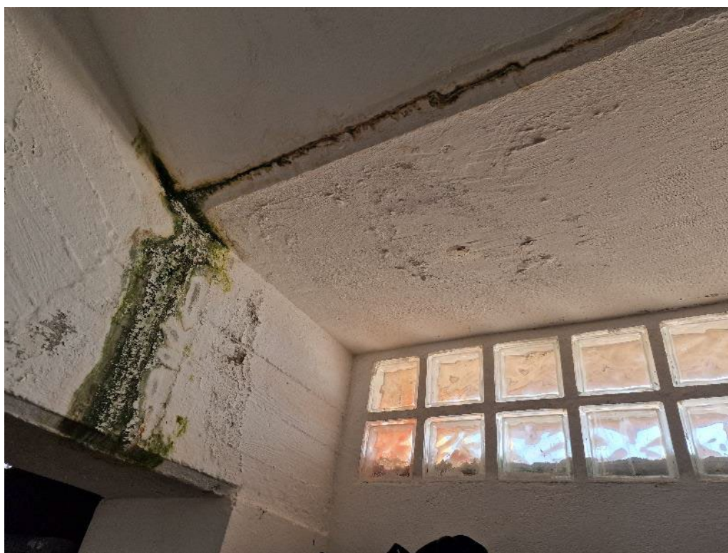
Foto 8 - Infiltrazioni interne dovute alla mancanza di impermeabilizzazione efficace
