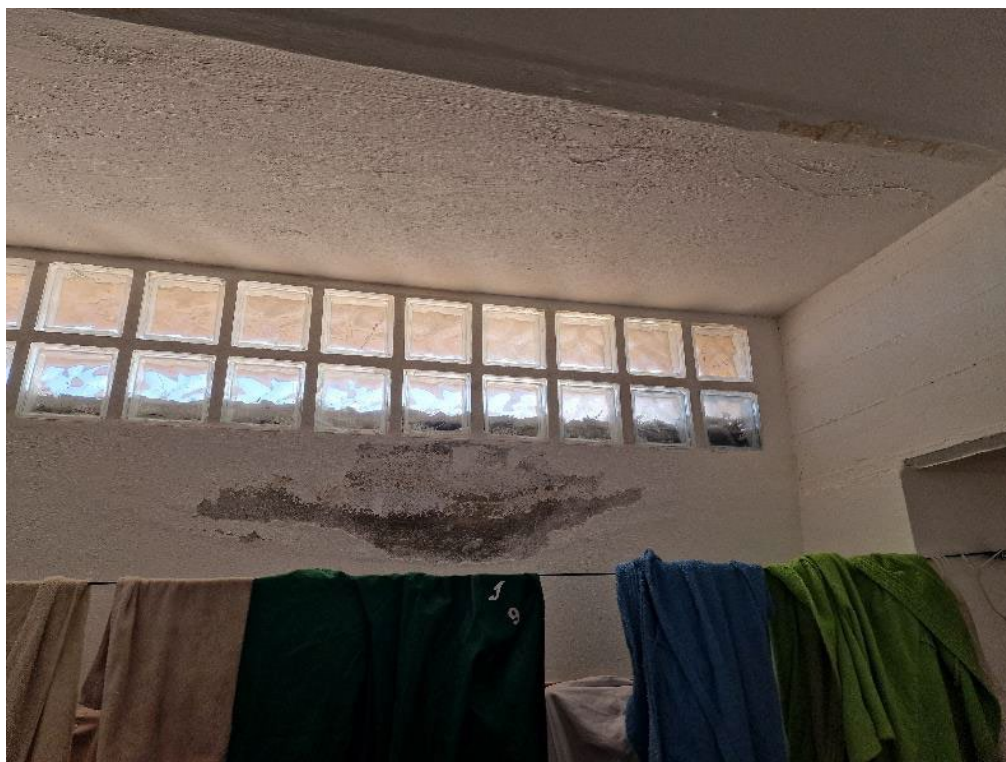
Foto 7 - Infiltrazioni interne dovute alla mancanza di impermeabilizzazione efficace
