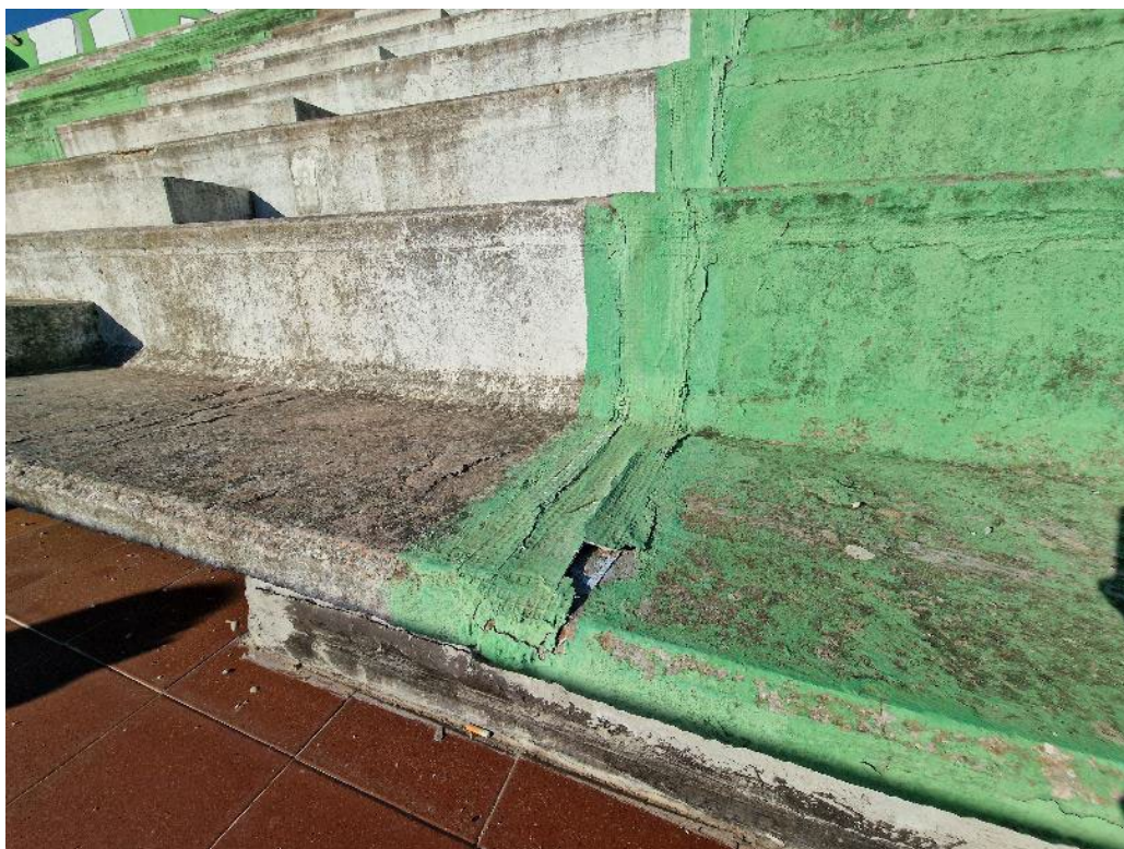
Foto 3 - I giunti verticali tra le sedute in cemento della tribuna.
