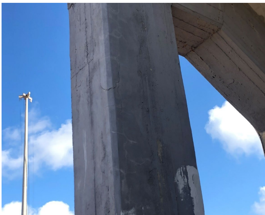
Foto 12 -Dettaglio di uno dei pilastri da risanare sul retro della tribuna.
