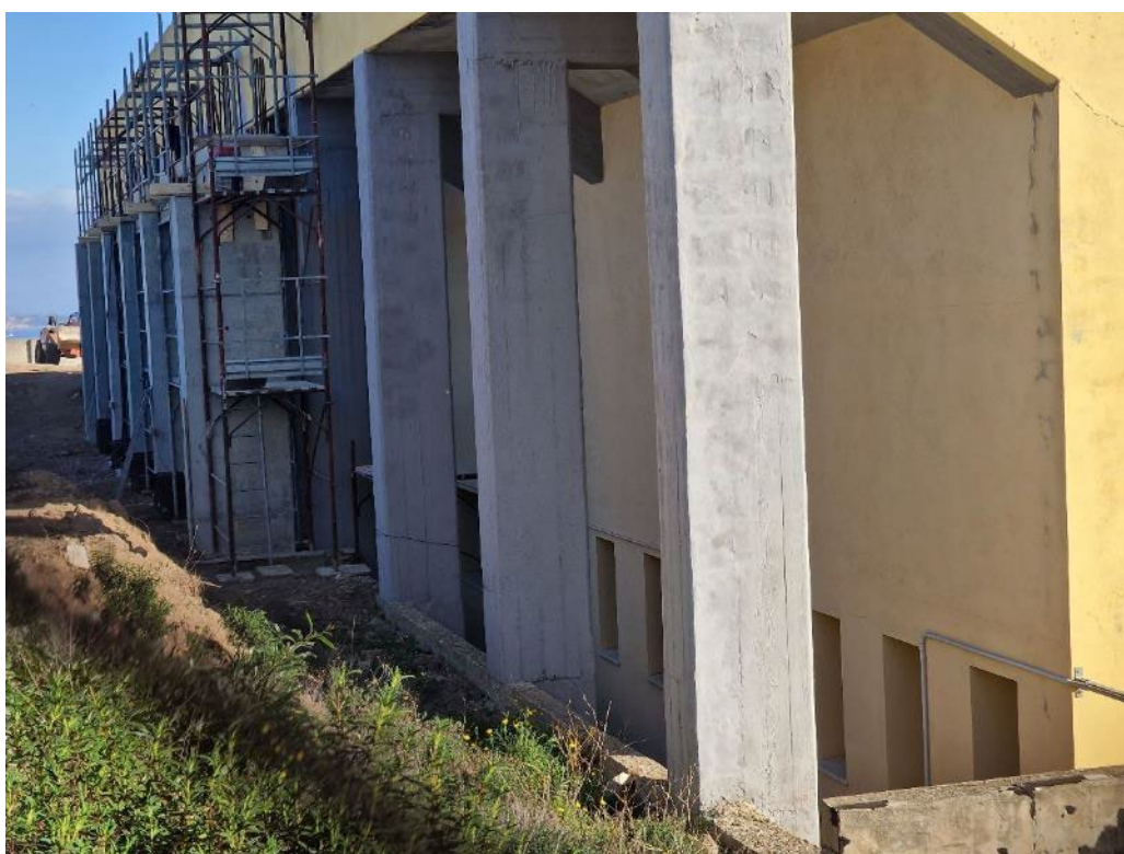
Foto 10 - Il retro della tribuna con il dislivello da mettere in sicurezza. Dettaglio.
