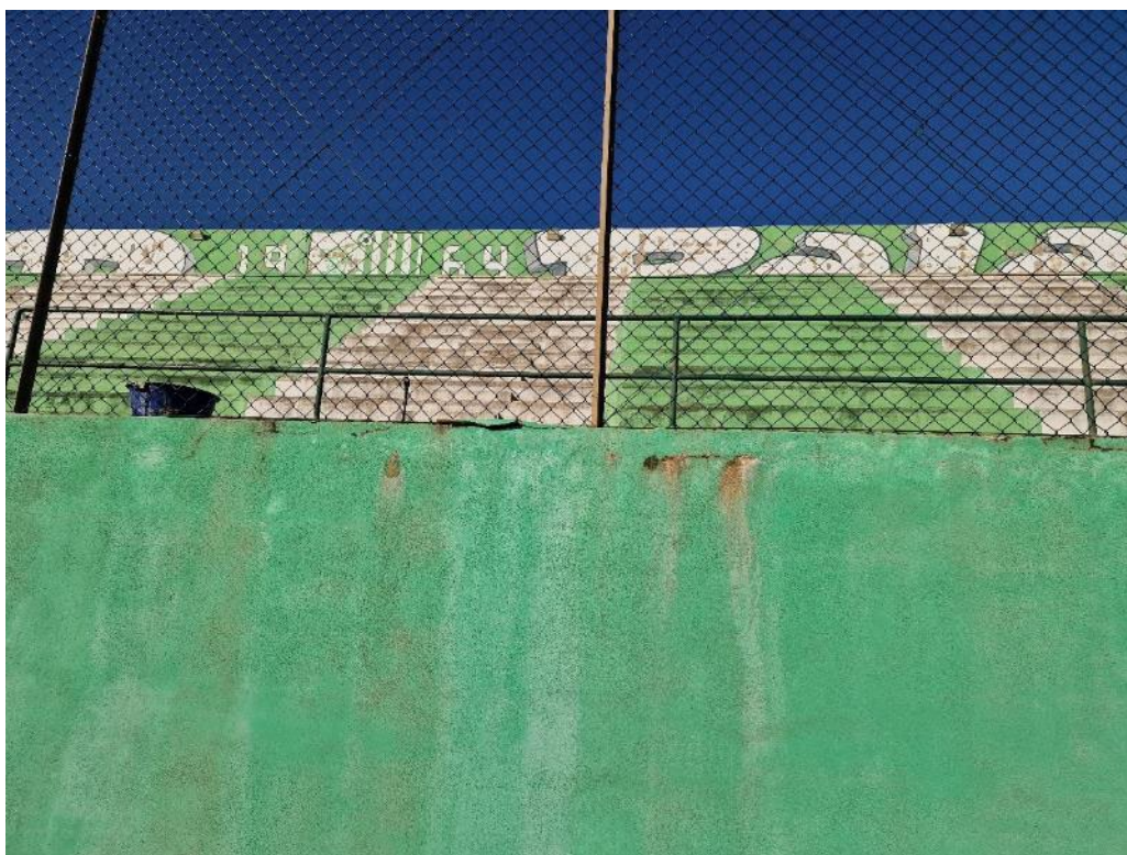
Foto 13 - Il muro della tribuna da proteggere e completare con scossalina.
