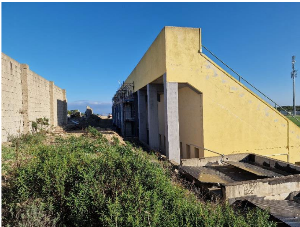
Foto 9 - Il retro della tribuna con il dislivello da mettere in sicurezza.
