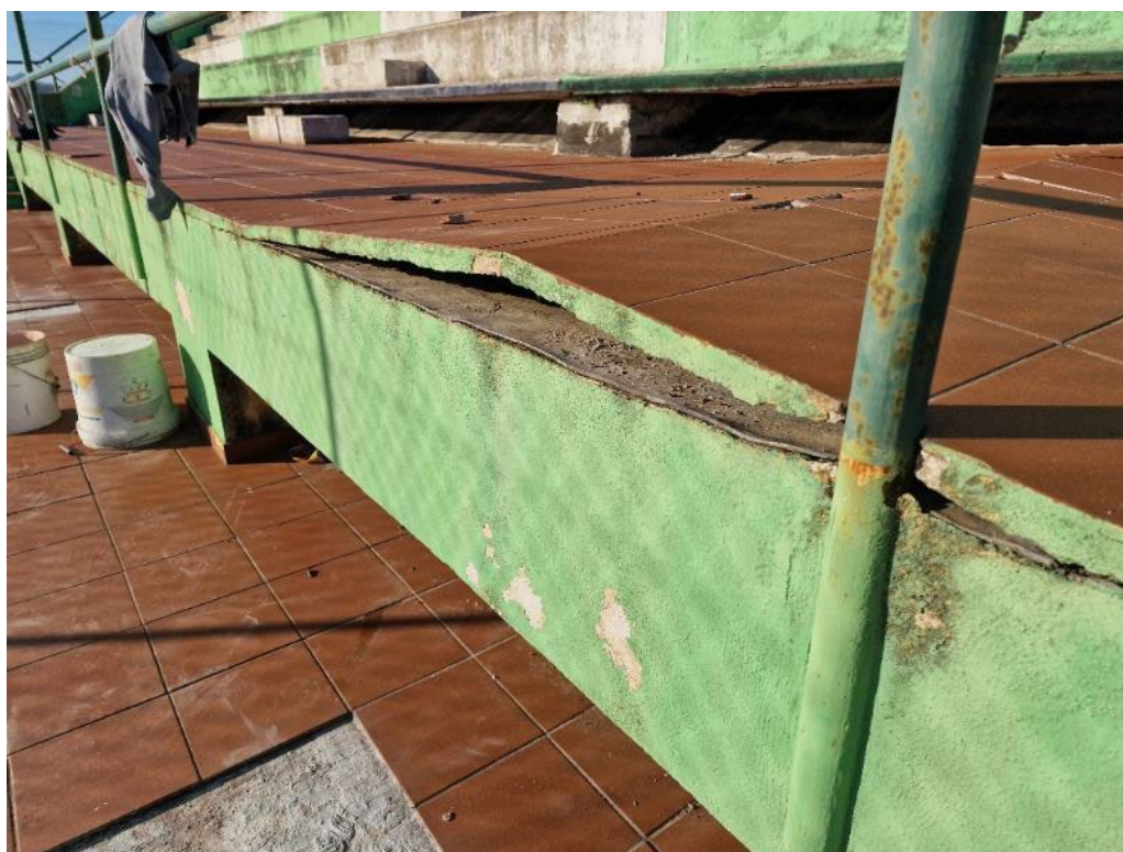
Foto 2 - La pavimentazione della tribuna. Dettaglio
