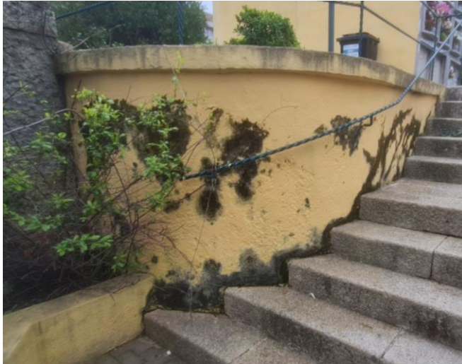
Presenza diffusa di muffe
