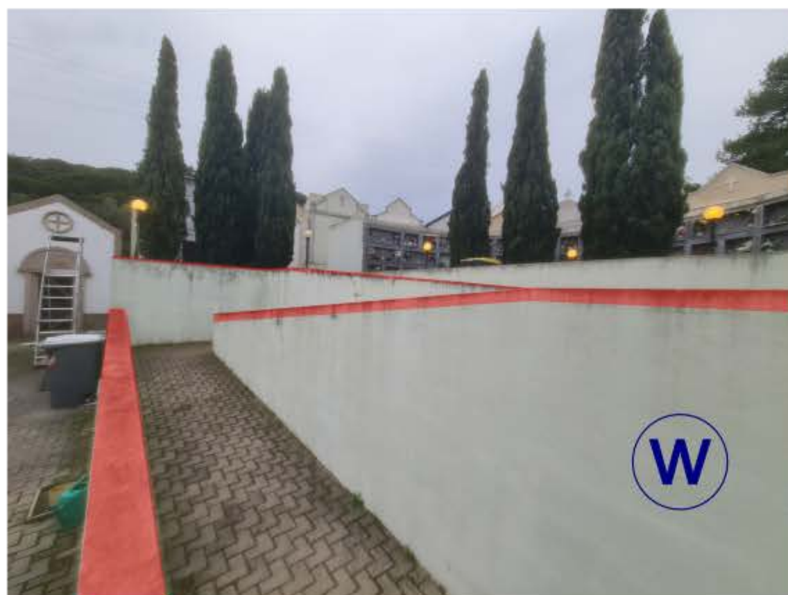
Risanamento dalle muffe della parte alta del parapetto
