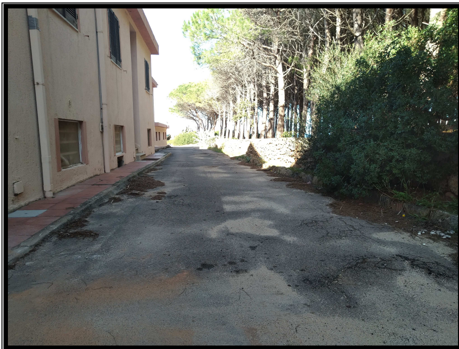
Apparati radicali degli esemplari del filare. Danneggiamento del manto stradale.
