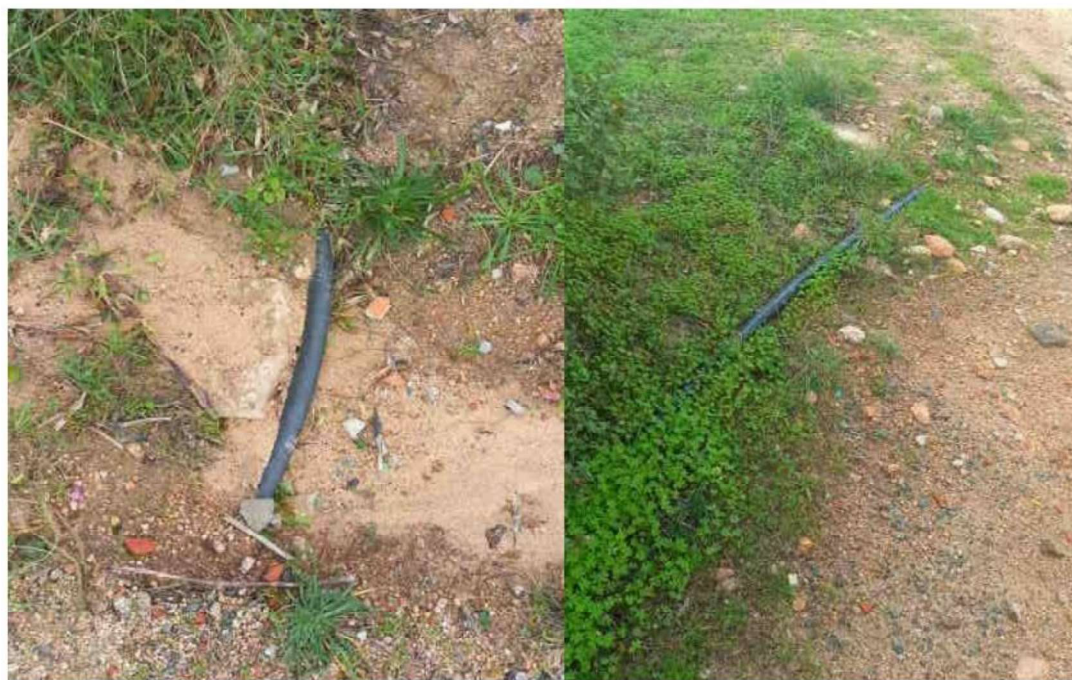
Fig. 1 – Tubazione in polietilene fuori terra
