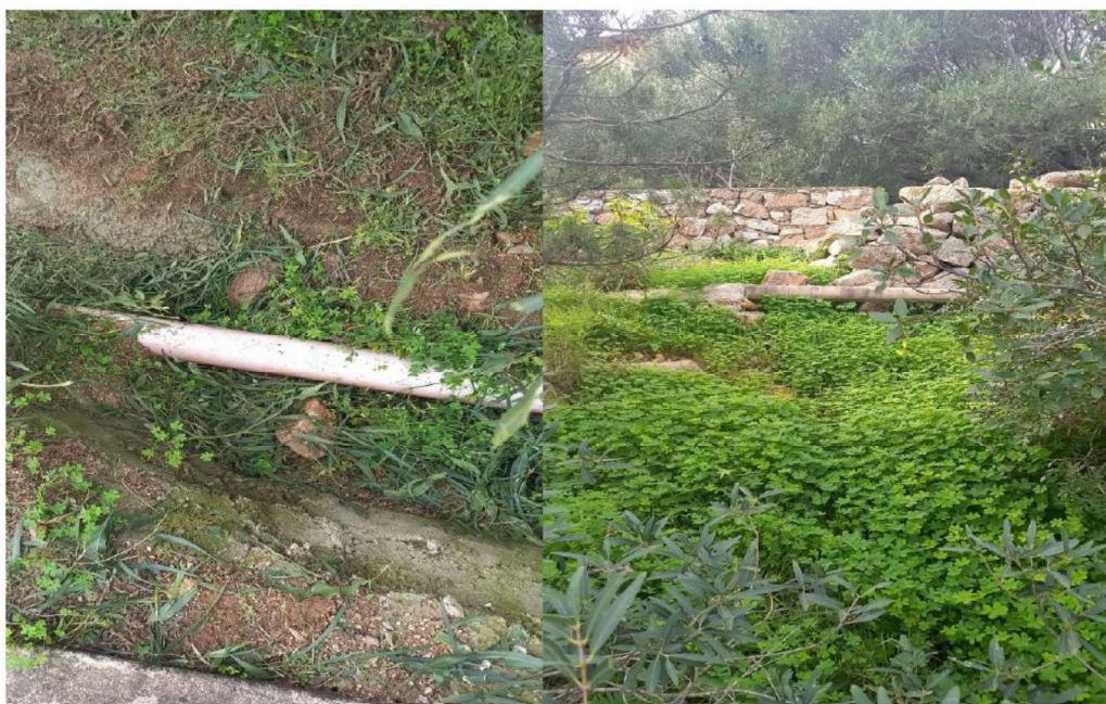
Fig. 6 – Tubazione fognaria a vista
