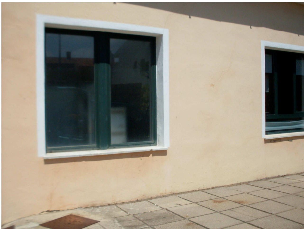
FOTO N°60 Vista su parete S con lineazioni di trazione per cedimento differenziato
