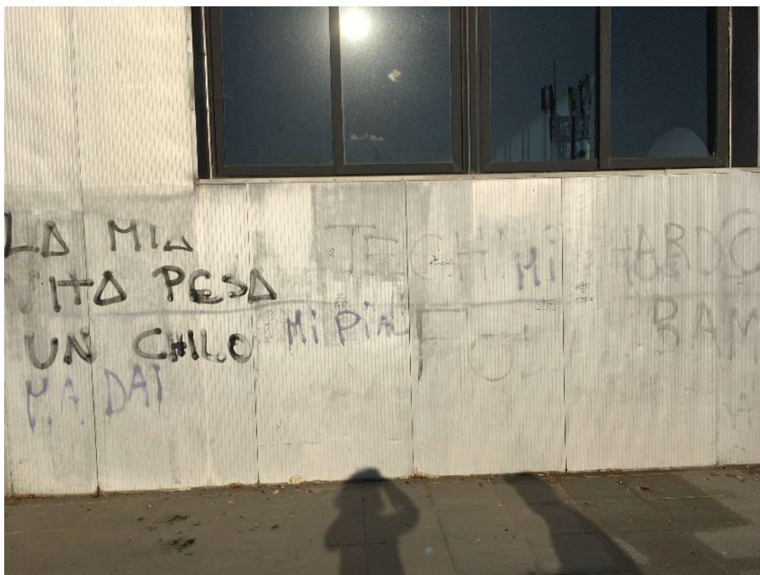
Foto 11 - Imbrattamenti vandalici sul fronte lato Montiggia
