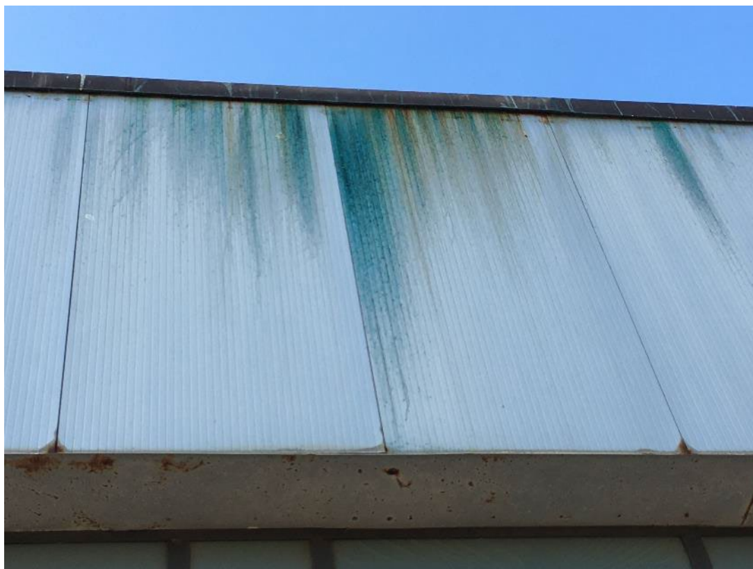
Foto 15 - Colature e percolazioni sulla pannellatura in alluminio
