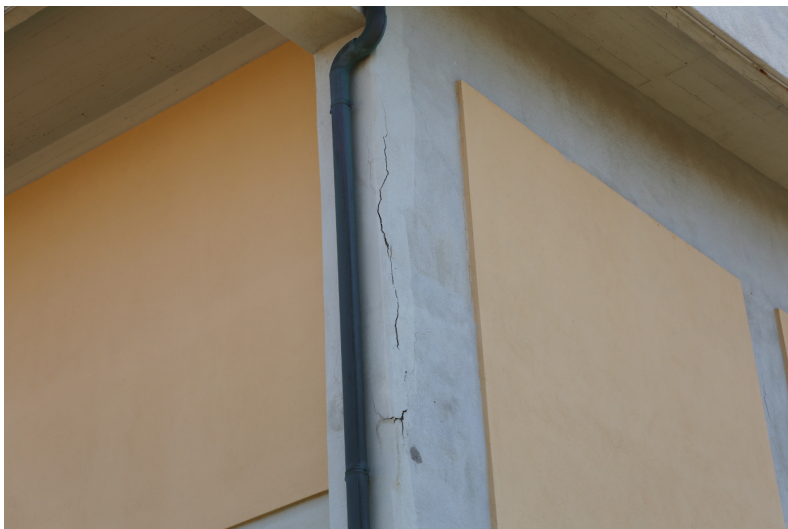
Foto 6 Alterazione dello strato copriferro negli elementi strutturali a vista - fenomeno diffuso che richiede intervento sollecito
