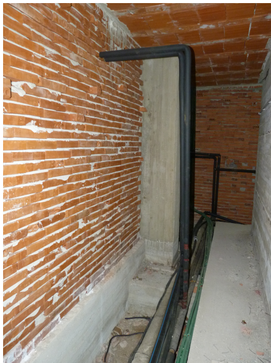
Foto 10 intercapedine tecnologica - stacchi da linea dorsale verso i collettori di alimentazione dei terminali – non sono presenti organi di bilanciamento delle portate
