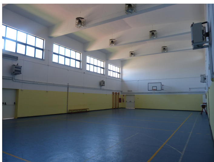
Foto 13 Aerotermi esistenti asserviti alla palestra
