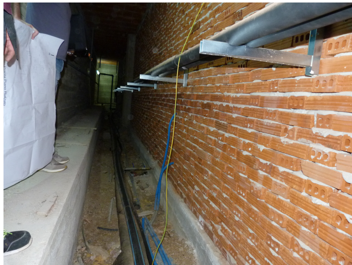
Foto 9 Intercapedine tecnologica - sulla destra le linee dorsali in rame con diametro 54 x 1.5 mm per mandata e ritorno impianto di riscaldamento
