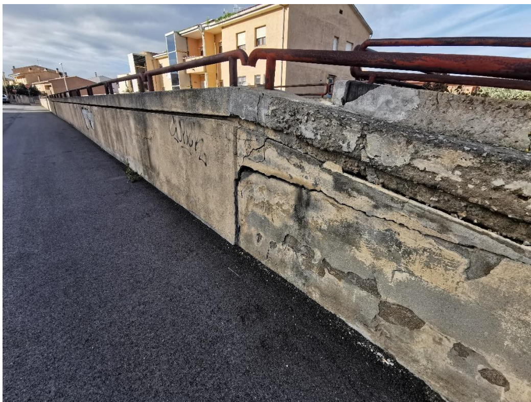
Foto 17 - Muretto del blocco garage lungo Via dei Lotofagi
