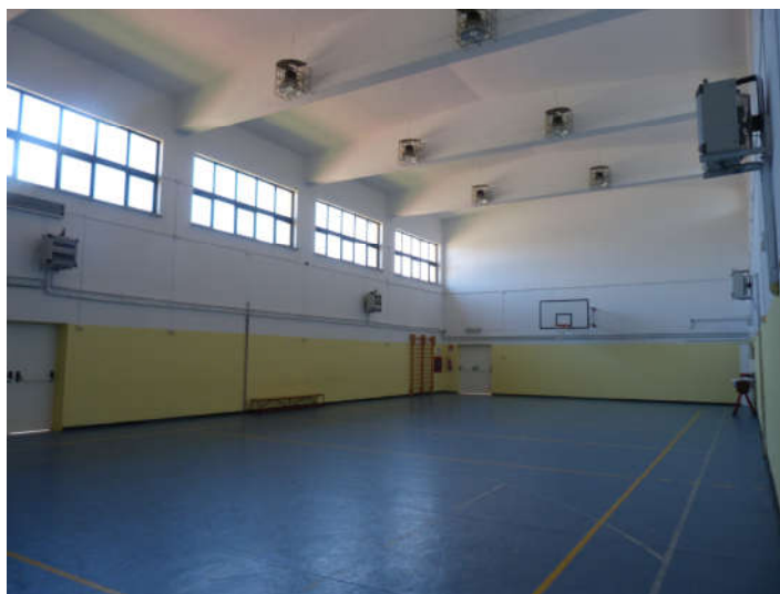
Foto 13 Aerotermi esistenti asserviti alla palestra
