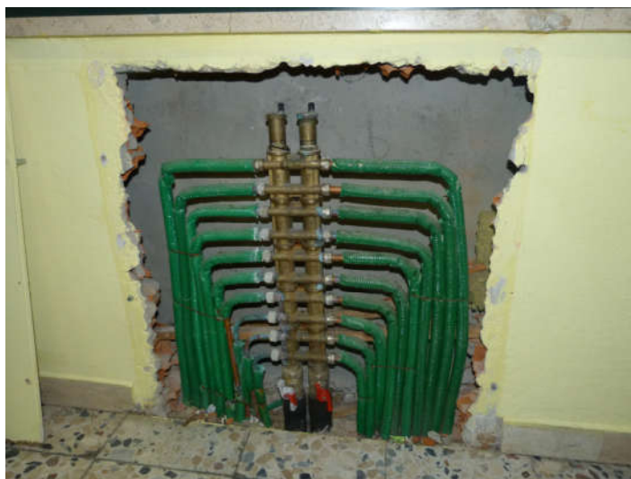
Foto 11 collettore tipo di distribuzione ai terminali di erogazione
