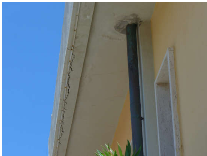
Foto 7 Alterazione del copriferro diffusa anche nei cornicioni in calcestruzzo armato
