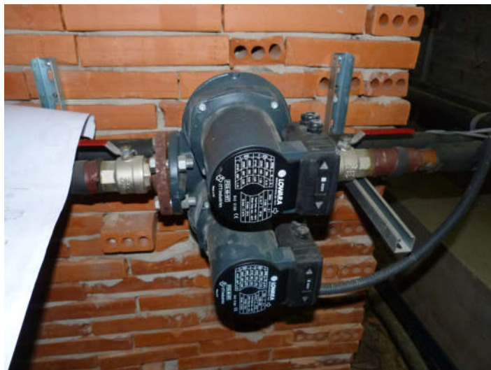
Foto 14 Circolatore supplementare installato su stacco linea alimentazione aerotermi
