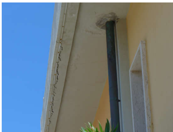
Foto 7 Alterazione del copriferro diffusa anche nei cornicioni in calcestruzzo armato
