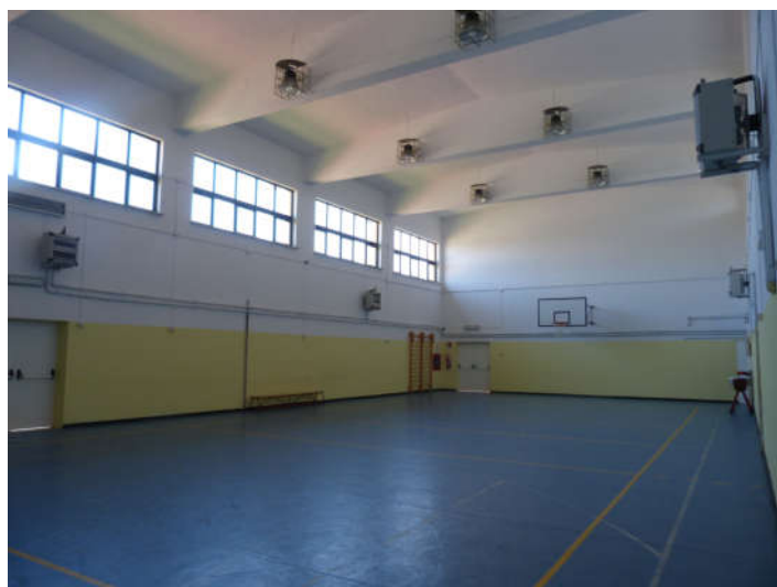
Foto 13 Aerotermi esistenti asserviti alla palestra
