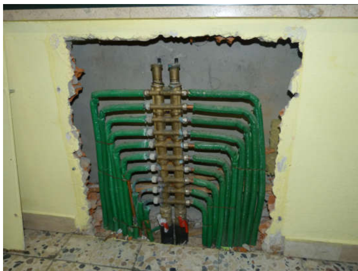
Foto 11 collettore tipo di distribuzione ai terminali di erogazione
